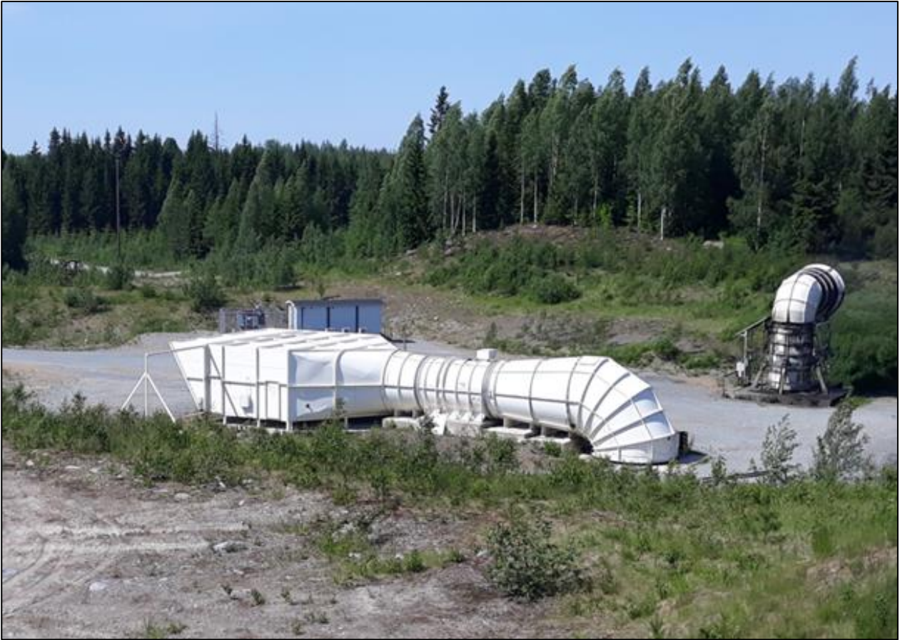
Kuva 9. Esimerkki tuuletusnouseista maanpinnalla (Kuva: Endomines Oy).
